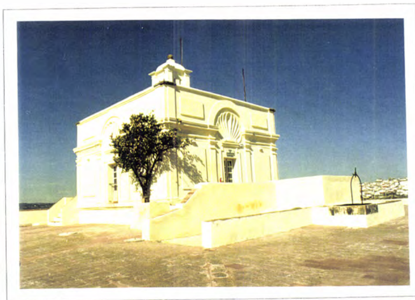
Fig. 6.4.65 - Forte de Santa Luzia. Casa do Governador e eirado (durante as obras de restauro, 1999)
