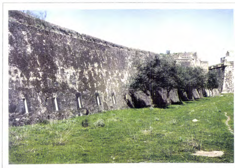
Fig. 6.4.73 - Forte da Graça. Frestas das casernas localizadas na base da contra-escarpa
