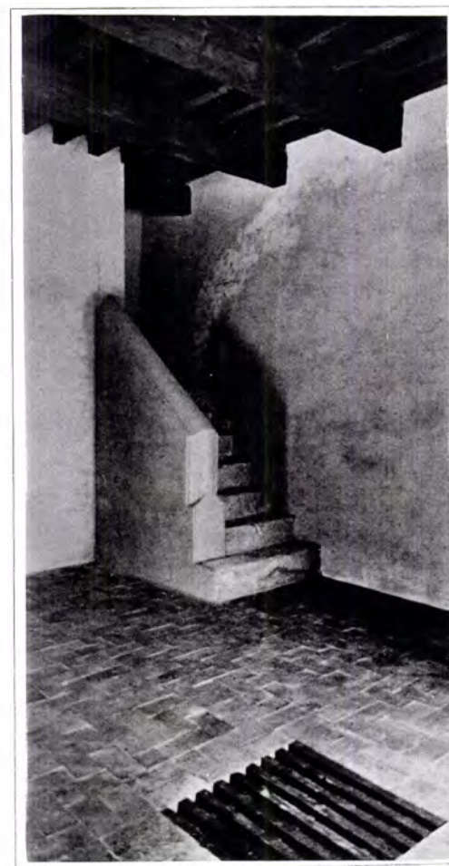
Fig. 6.5.29 - Castelo de Belver. Segundo piso da Torre de Menagem depois da interv. de 1935 a 1946 (foto DGEMN).
