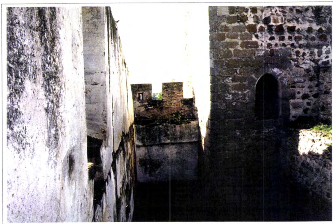
Fig. 6.1.27 - Castelo de Alter do Chão. Topo SO da alcaidaria ao nível do 2º andar
