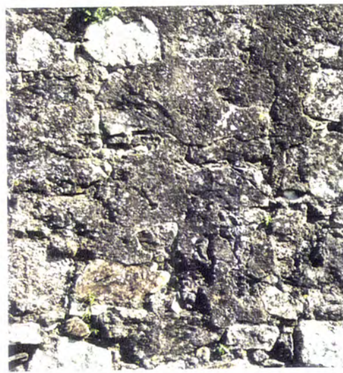
Fig. 6.4.86 - Fortificações abaluartadas de Elvas. Paramento com vestígios de reboco
