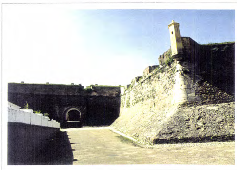
Fig. 6.4.54 - Fortificação abaluartada de Elvas. Poterna da cortina entre o Baluarte da Porta Velha e o Baluarte do Casarão
