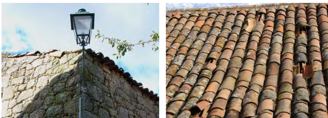
Ilustração 51 - Edifício n.º2 com cobertura danificada e ausência de telhas (Ilustração nossa, 2012).
