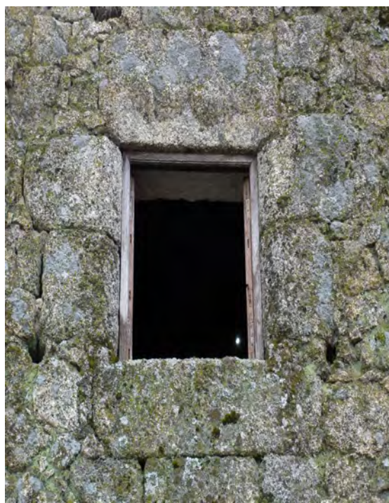
Ilustração 58 - Edifício n.º2 Fachada de alvenaria de granito evidenciando colonização biológica com instalação de musgos e líquenes (Ilustração nossa, 2012).
