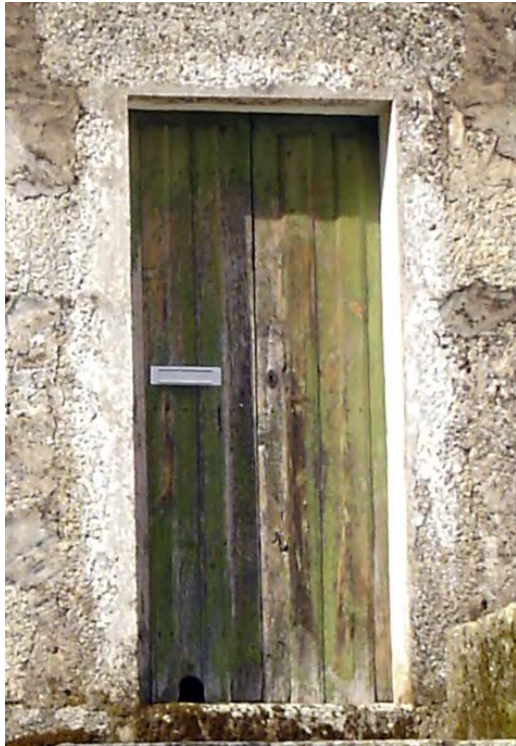
Ilustração 54 - Edifício n.º1 porta de madeira deteriorada, desagregação da pintura (Ilustração nossa, 2012).
