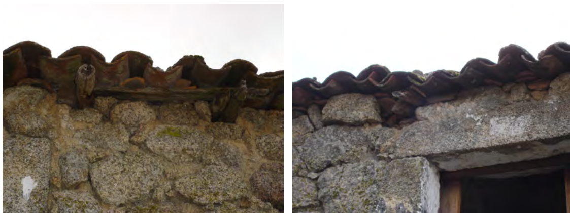
Ilustração 50 - Edifício n.º2 com estrutura e revestimento da cobertura danificadas (Ilustração nossa, 2012).
