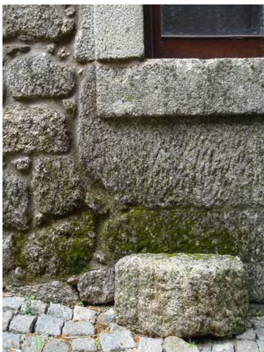
Ilustração 57 - Edifício n.º3 Colonização biológica na fachada, evidenciando infiltrações por capilaridade (Ilustração nossa, 2012).
