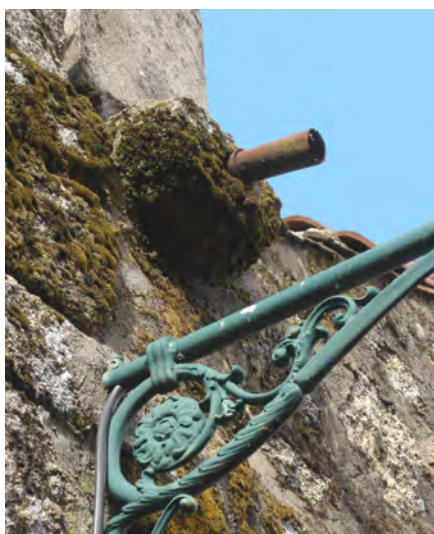
Ilustração 53 - Edifício n.º4 dreno oxidado, ausência de tubo de queda (Ilustração nossa, 2012).
