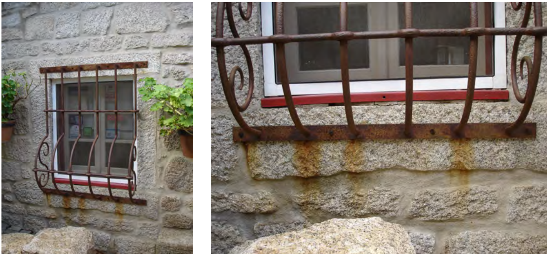
Ilustração 52 - Edifício n.º4 guarda de ferro oxidada (Ilustração nossa, 2012).
