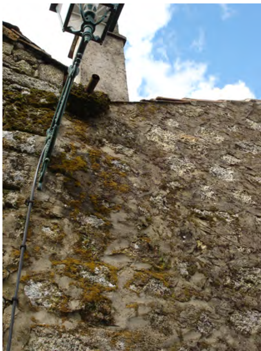
Ilustração 59 - Edifício n.º1 Colonização biológica na ligação entre a pedra e a argamassa (Ilustração nossa, 2012).
