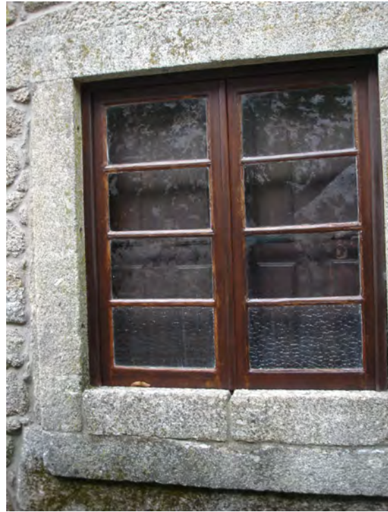
Ilustração 55 - Edifício n.º3 massa de vidraceiro ressequida e fendilhada (Ilustração nossa, 2012).
