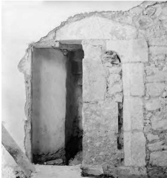
Descoberta de parte de um portal de vão antropomórfico que estava a fazer parede junto à porta da torre sineira (SIPA FOTO.00166883, 1969)
