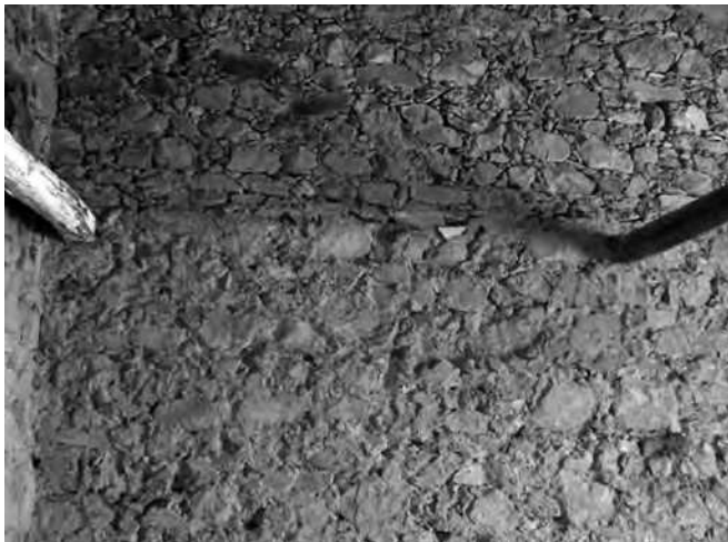
Paramento sem reboco mostrando a fiada de pedra mais regular que serviu para fazer o ensoleiramento para colocação de barrotes onde assentará o respectivo piso, neste caso de uma sobrecama (Rua 24 de Janeiro)
