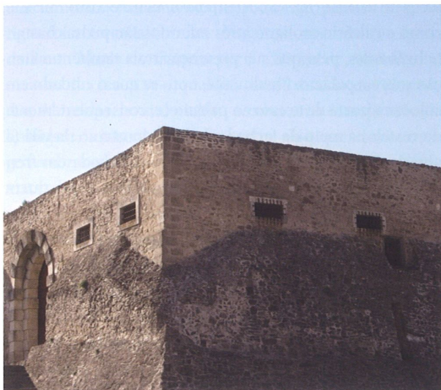
Fig. 6 | Cunhal entre as fachadas da porta e a fachada intermédia. A janela de chanfro quinhentista é a primeira do lado direito.
