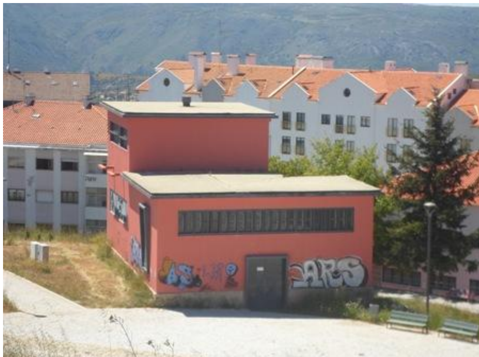
Outro posto de seccionamento localizado nas imediações da Torre de Menagem. (Fonte: Vanessa Pita, 2013).
