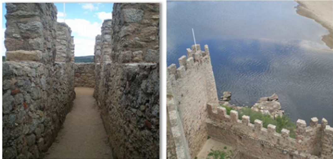
Vista interior do Adarve com duplo parapeito. b) Vista superior, à esquerda, do Adarve com duplo parapeito.
