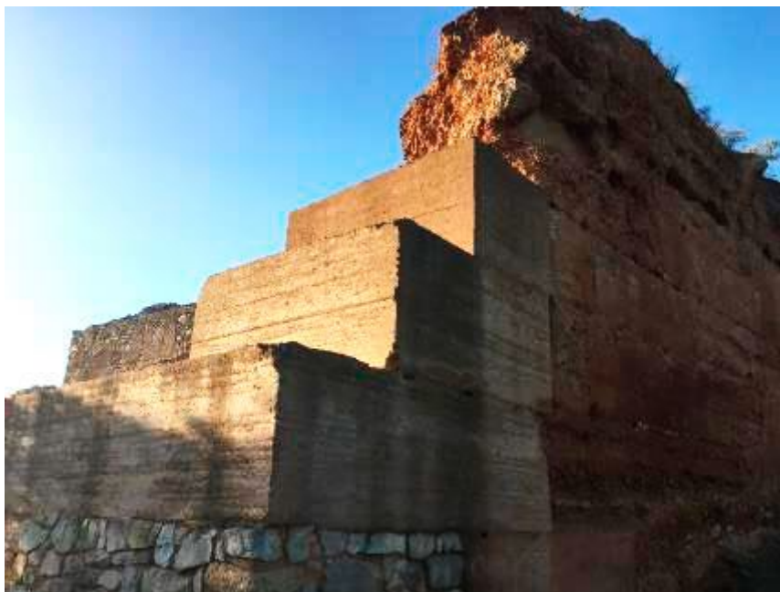
Figura 2. Foto de 2018 mostrando os módulos de taipa executados em 2004 para reparação de degradação na muralha Sul.
