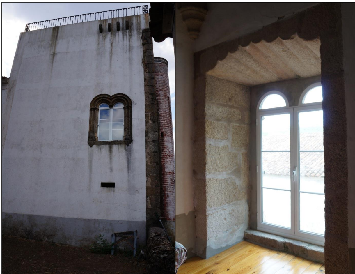
50. Fachada Este (à esquerda) e enxalço da janela em duplo arco (à direita)
