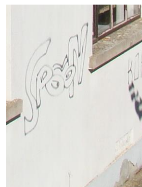
Figura 36 Vandalismo na antiga escola
