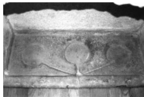
Fig. 6. Vista das cavidades e pequenas caleiras que compõem a base do vão inferior do armário.
