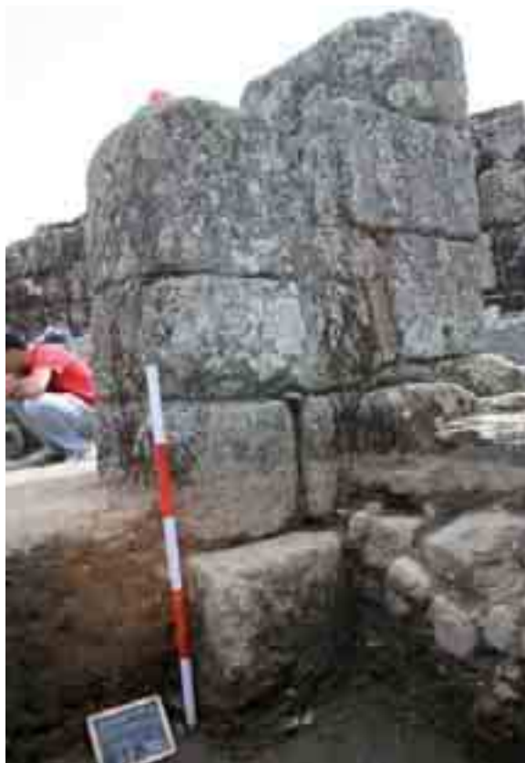
Fig. 117. Zapata de cimentación del pilar adosado a la fachada occidental del edificio tardoantiguo (SII/U.E.12).
