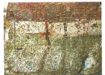
Fig. 5 - Pilar esquerdo. Restos pintura, a vermelho-acastanhado, da última fase de utilização da capela. Escorrimentos de tinta sobre o refechamento da junta sobre a imposta.
