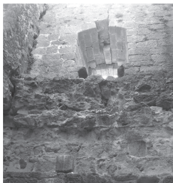
Fig. 27 – Pormenor da abóbada da torre de menagem derrubada.
