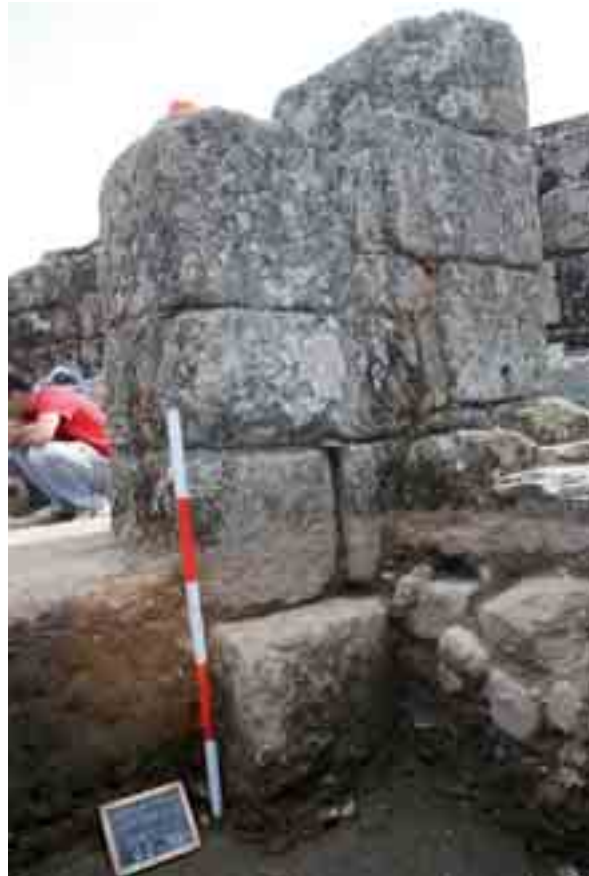
Fig. 117. Zapata de cimentación del pilar adosado a la fachada occidental del edificio tardoantiguo (SII/U.E.12).
