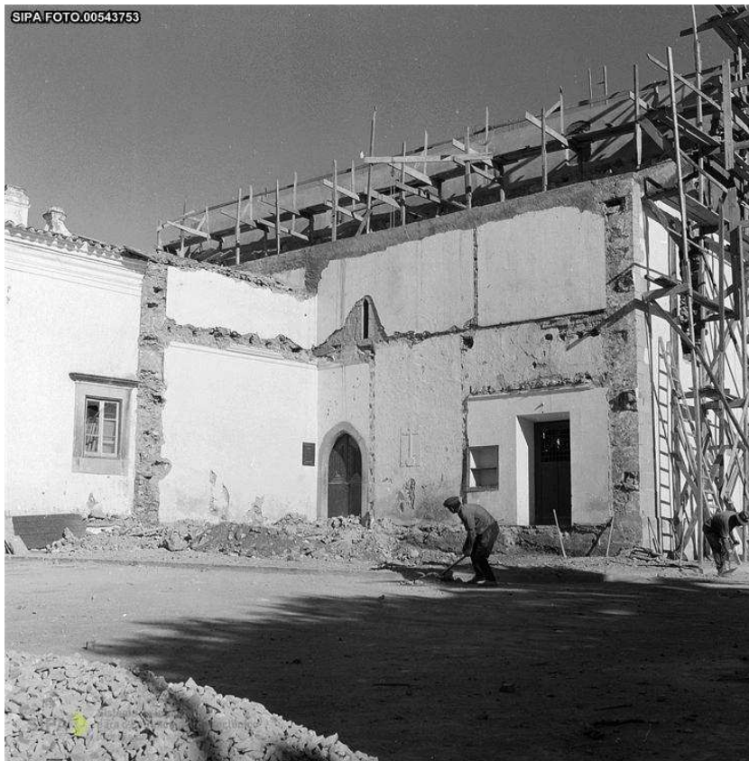
Fig.27 - Vista Lateral esquerda da Igreja de S. Clemente depois de 1961 (depois do início da campanha de obras) com uma das frestas desentapadas assim como o portal lateral posto a descoberto Fonte: SIPA
